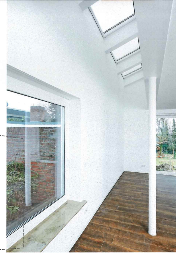
Zusätzliches Licht von oben: Für das Lichtband wurden Stahlträger eingezogen und ein Kombirahmen mit fünf Fenstern eingesetzt.
